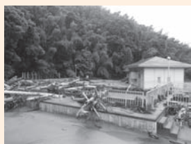
被災した杷木浄水場
