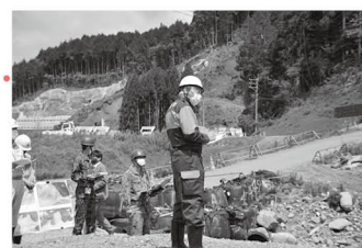
▲高木地区(黒川)で、崩落した山肌の復旧状況を確認する林市長
