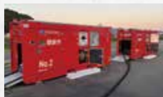
▲原鶴地区の排水ポンプ
