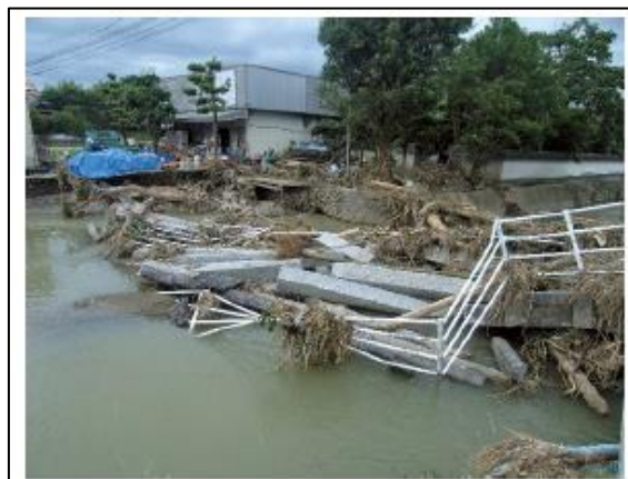
久保島の石造桁橋 被災状況
