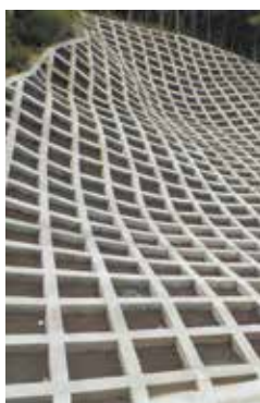
災害により被災を受けた林道米の山線
