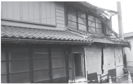
倒壊の危険に近隣住民はいつも不安である
