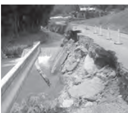
地盤が脆弱な杷木地域に導水管敷設は危険
