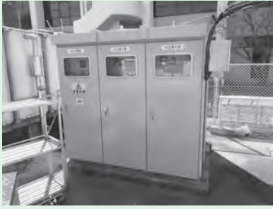
更新されたファームステーションバサロのキュービクル施設
