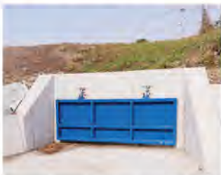
今春完成した大塚堰のフラップゲート
