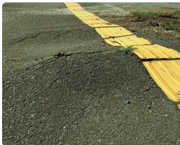
根が盛り上がった歩道
